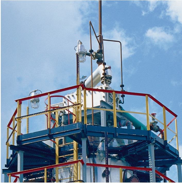
기동에 직접 장착된 완전용접형 열교환기(Compabloc) 리플렉스 콘덴서
