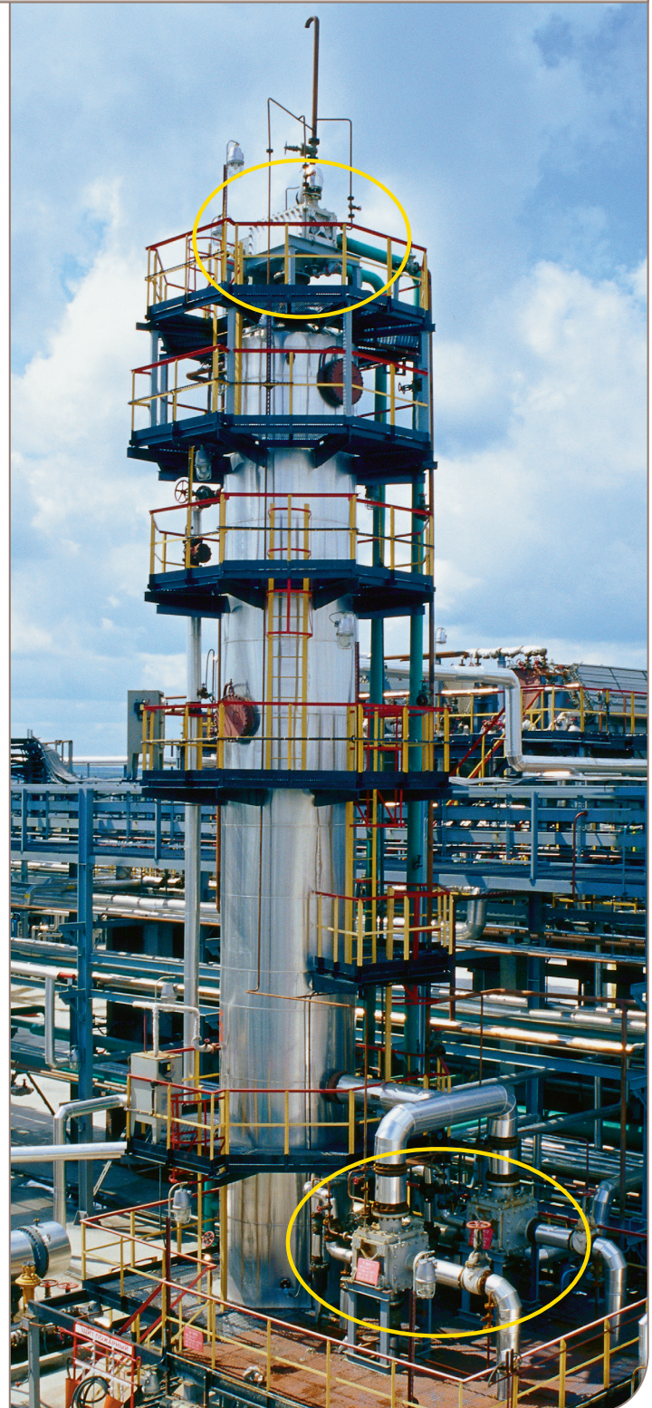
가스 스위트닝 공정의 스트리퍼 타워 (동그라미로 리보일러 및 리플렉스 콘덴서 표시, 다음 페이지에 클로즈업 수록)
