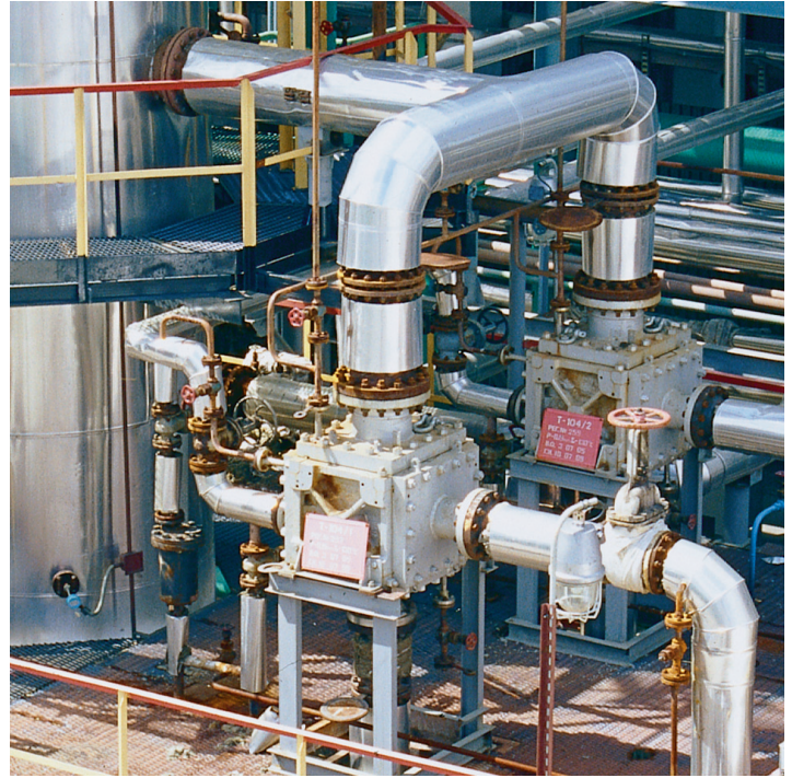
수증기를 열 매체로 하여 작동하는 Compabloc 열교환기 리보일러
